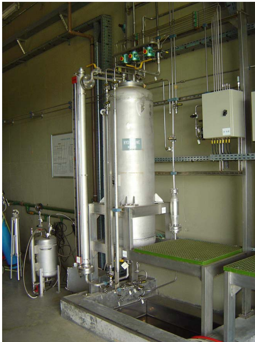
FIGURA 3.6 - Tanque de hidrazina anidra.
