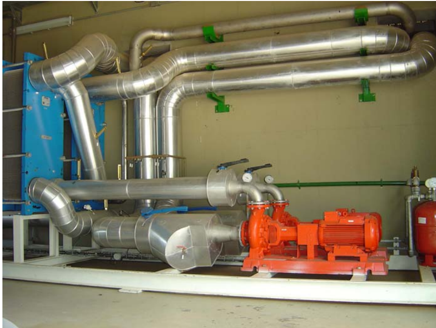
FIGURA 3.9 - Sistema de refrigeração.
