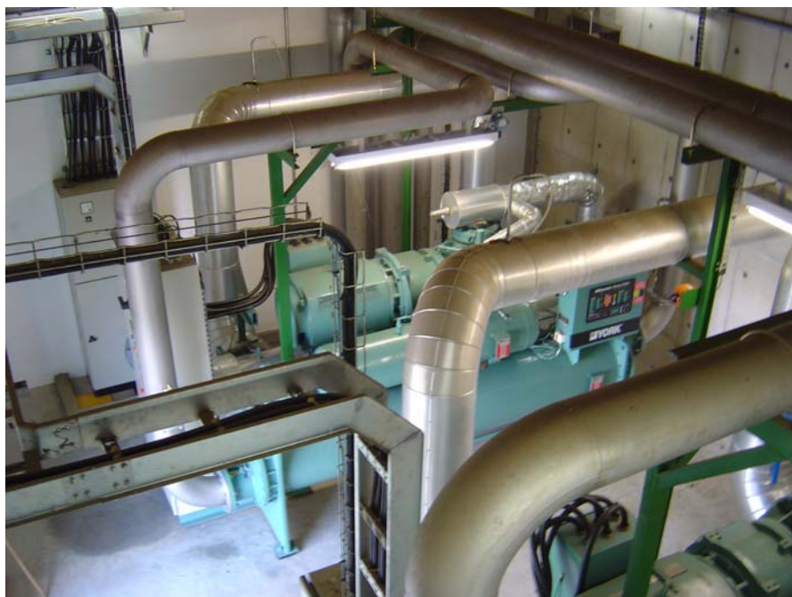
FIGURA 3.7 - Compressores de amônia.
