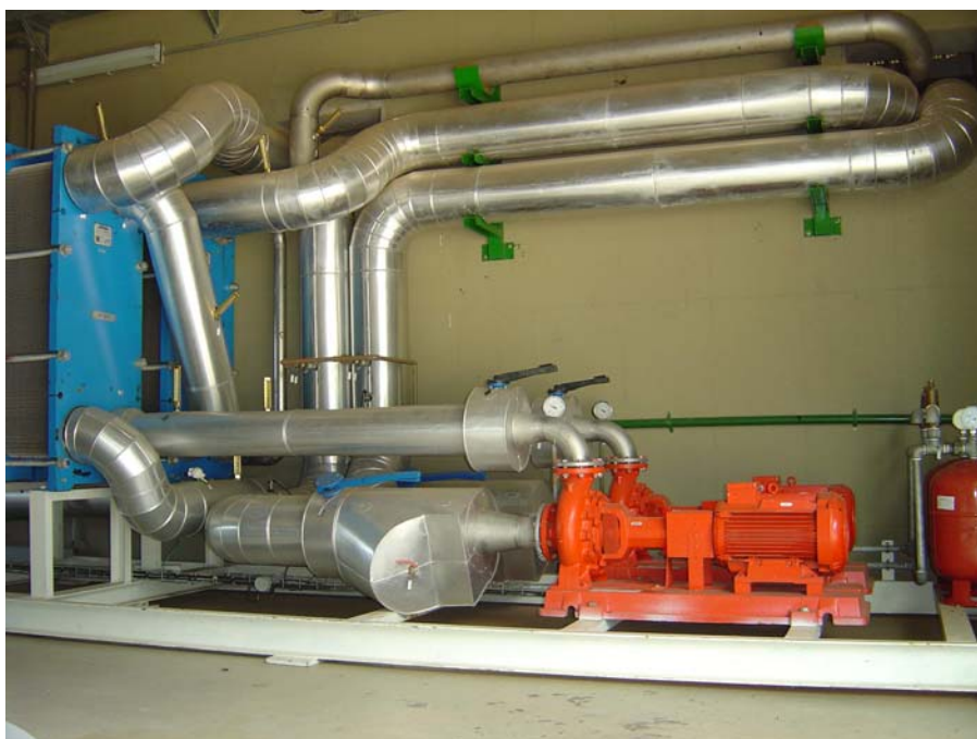
FIGURA 3.9 - Sistema de refrigeração.
