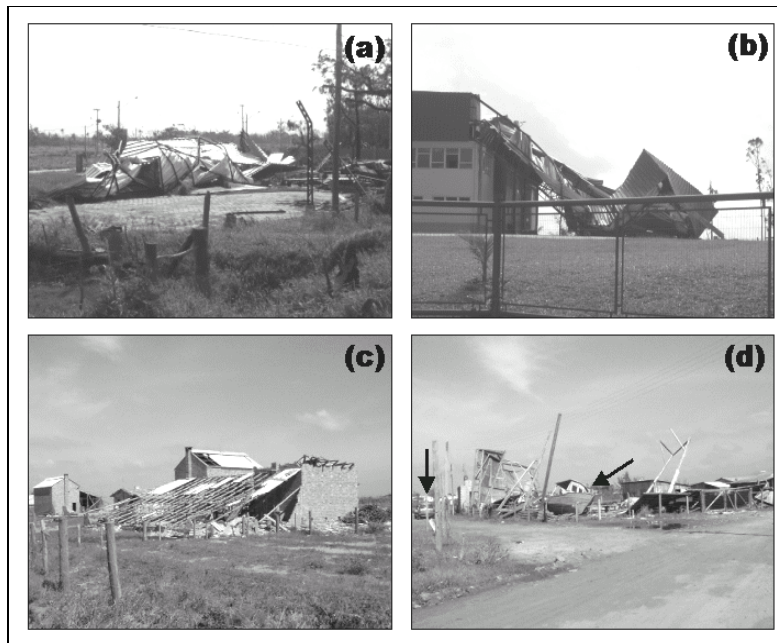
Figura 7 – Tipos de danos causados em galpões pela ação dos ventos: (a e b) destruição total e parcial de galpões metálicos; (c) destruição parcial de estufa de fumo; e (d) destruição total de um estaleiro.
