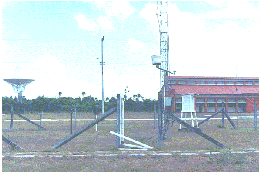
FIGURA 3.5 - Estação meteorológica automática MILOS 500- Vaisala.
