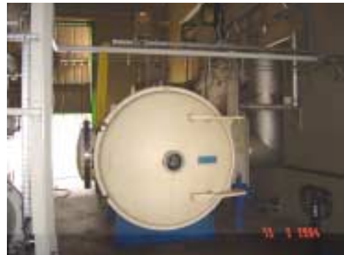
Figura 7 - Banco de 20N – Câmara fechada.
